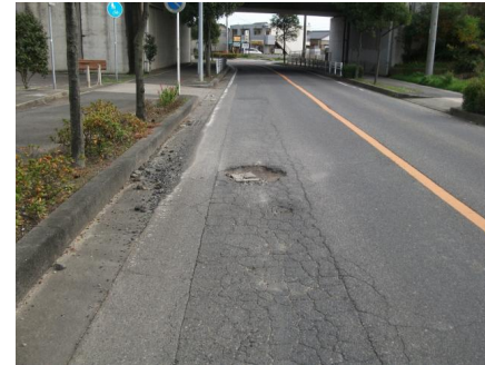
▲破損した道路
